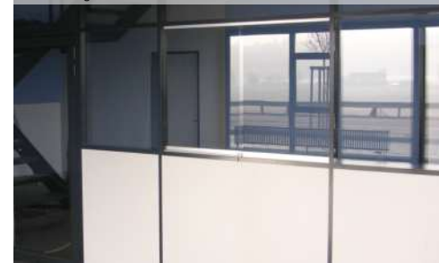
Glasschalteranlagen in Trennwand eingebaut Guichet intégré à la cloison
