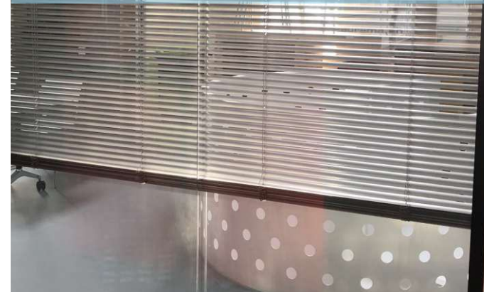
Lamellenstoren zwischen Glasscheiben in Trennwand eingebaut, Bedienung elektrisch Stores à lamelles intégrés à la cloison, commande électrique
