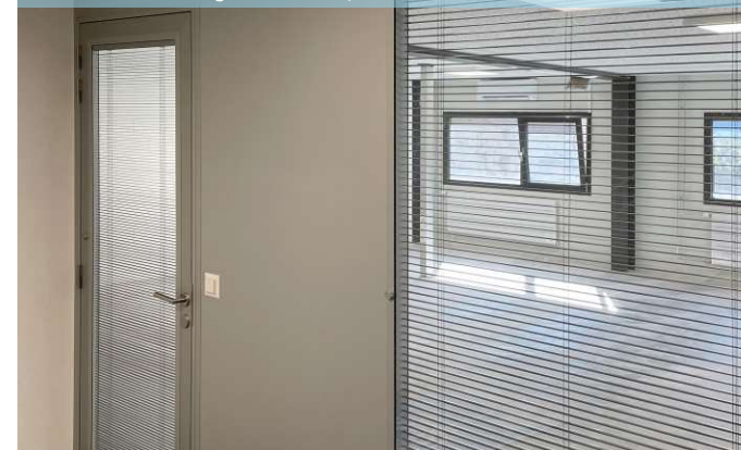
Lamellenstoren zwischen Glasscheiben in Trennwand eingebaut, Bedienung manuel Stores à lamelles intégrés à la cloison, commande manuelle
